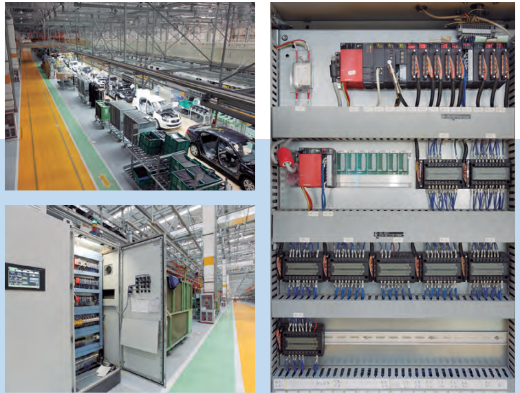
一汽轎車股份有限公司の第2工場の内部とそこに設置されたCC-Link機器
